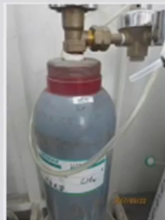
甲烷气瓶无泄漏报警
