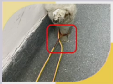
实验台防静电接地直接与水管连接
