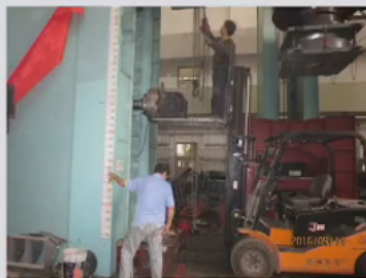
高处作业未佩戴个人防护装备
