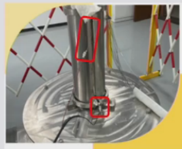
自制设备导线裸露，金属外壳未可靠接地
