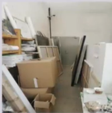
疏散通道堆放杂物
