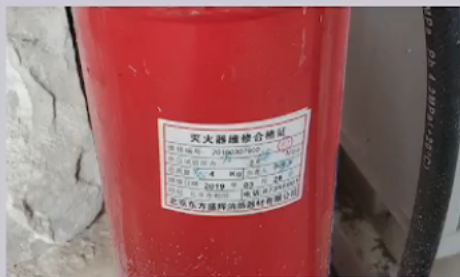
灭火器不在有效期内
